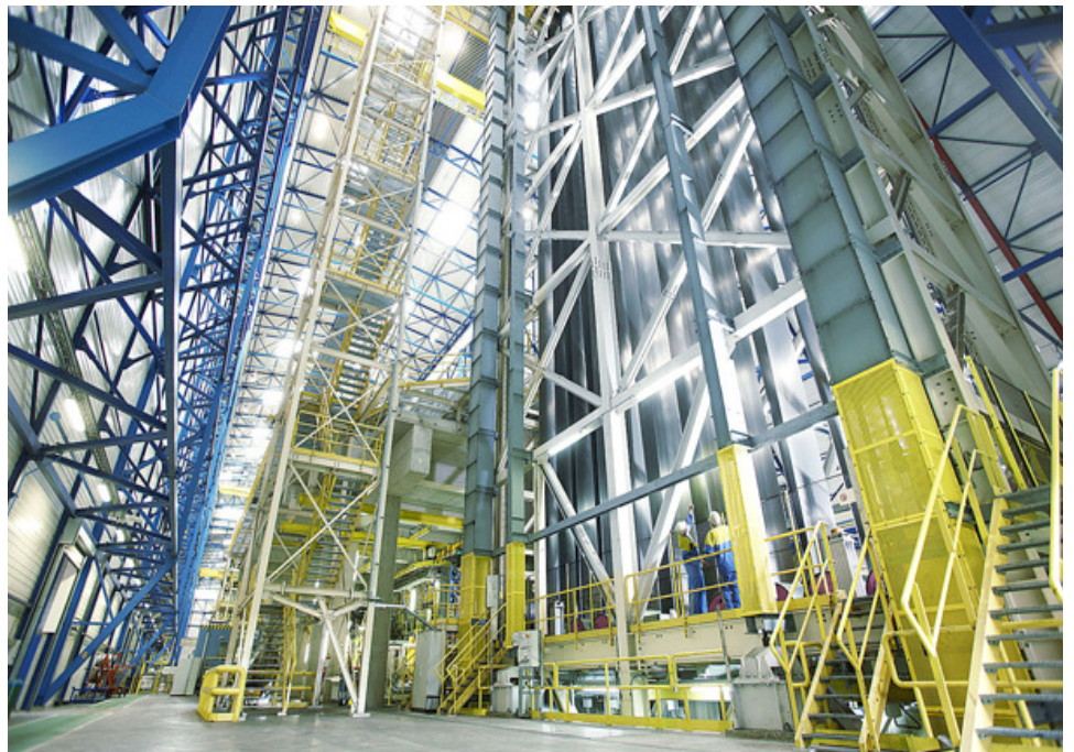
In de dompelverzinklijn worden de rollen staalplaat voorzien van een zinkcoating ter bescherming tegen corrosie. In de bufferzones kan het staalplaat via rollen naar een hoogte van 25 m worden geparkeerd.
